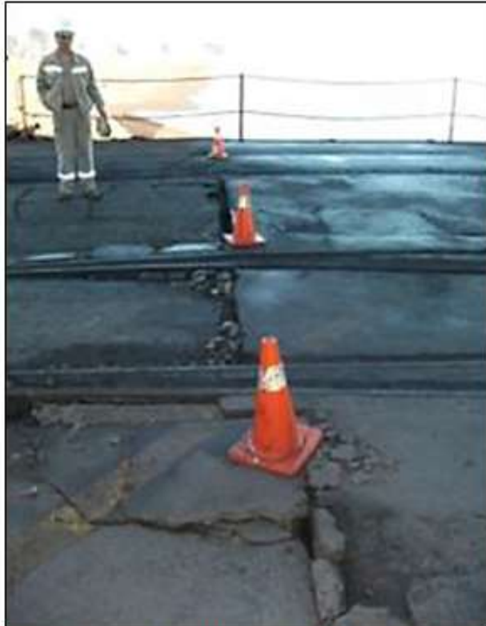
Figura D.32: Grieta en la loza del muelle (sector del puente de acceso). FUENTE: MUELLE CAPHUACHIPATO.
